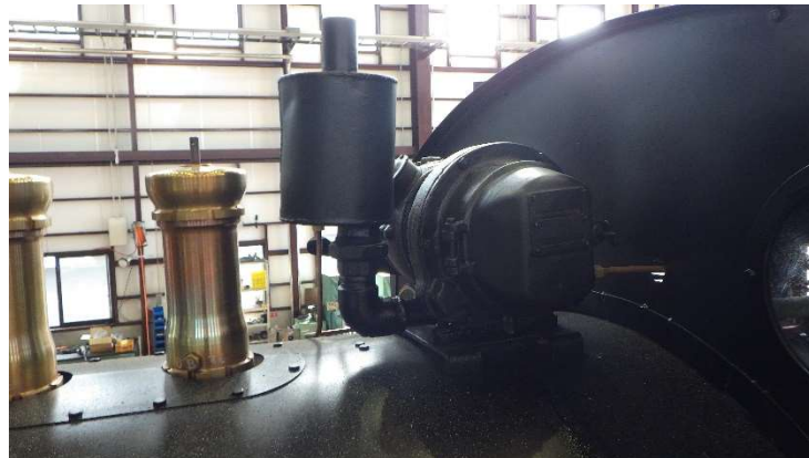
S Lに搭載されたタービン発電機
